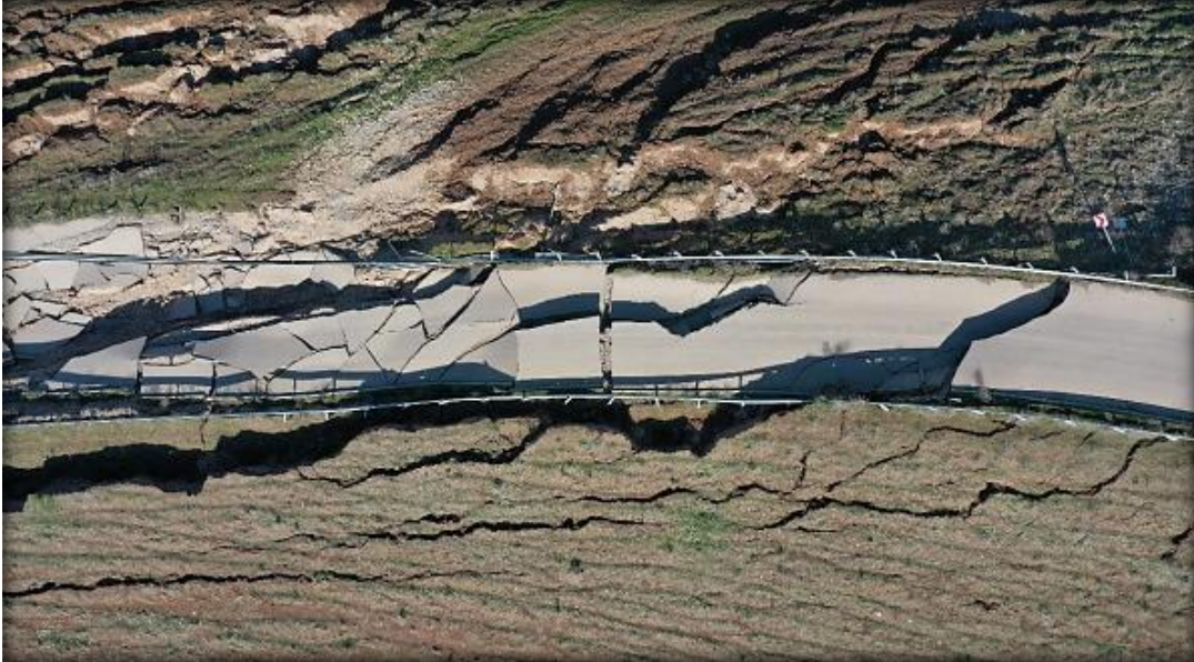
Şekil 10. Depremin Karayolu Üzerindeki Etkisi (Kaynak: SBB,2023)
