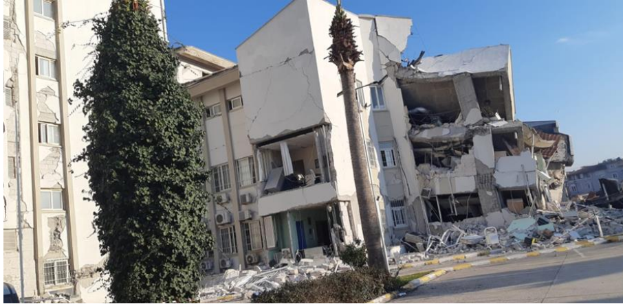
Şekil 3. Deprem sonrası Hatay'dan bir görünüm
