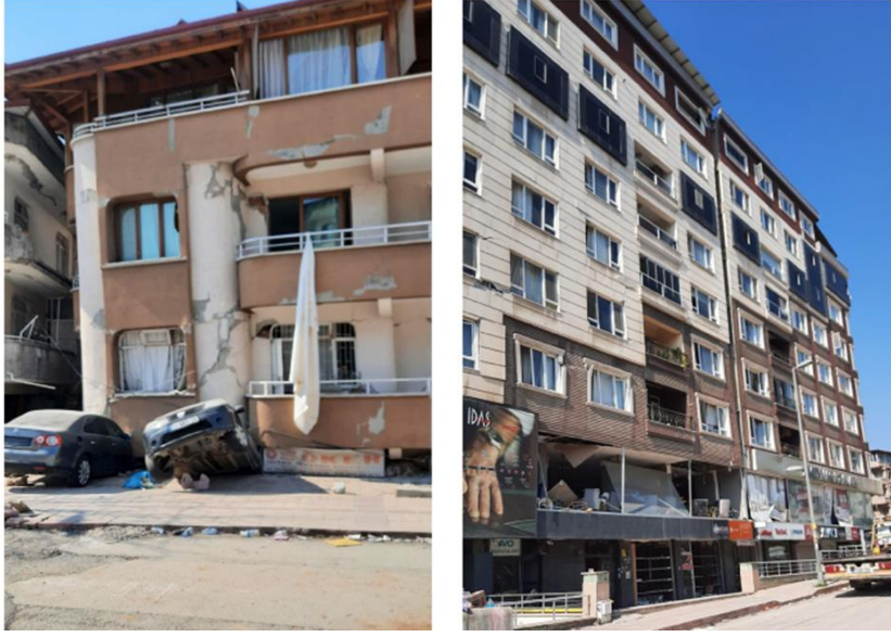
Şekil 7. Hatay kent merkezi ağır hasar gören ve yıkılan yapılar (TMMOB s.24).
