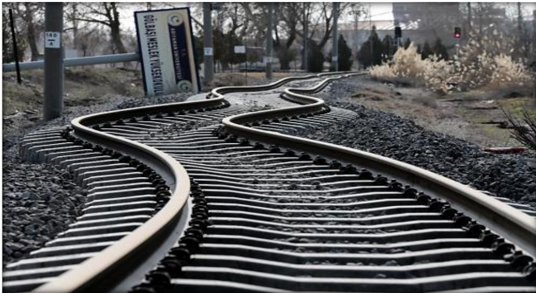
Şekil 9. Depremin Demir Yolu Üzerindeki Etkisi (Kaynak: SBB,2023)
