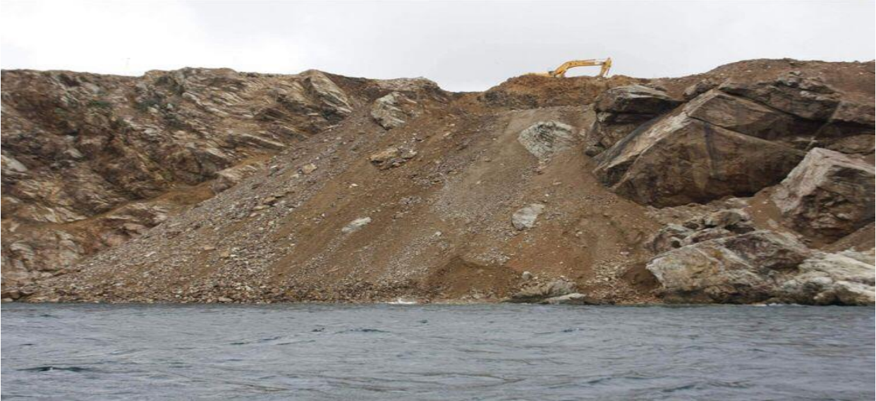
Fotoğraf 8. İnşaat hafriyatlarının denize dökülmesi mercanların zarar görmesine sebep olmaktadır (Magmadergisi, 2021)
